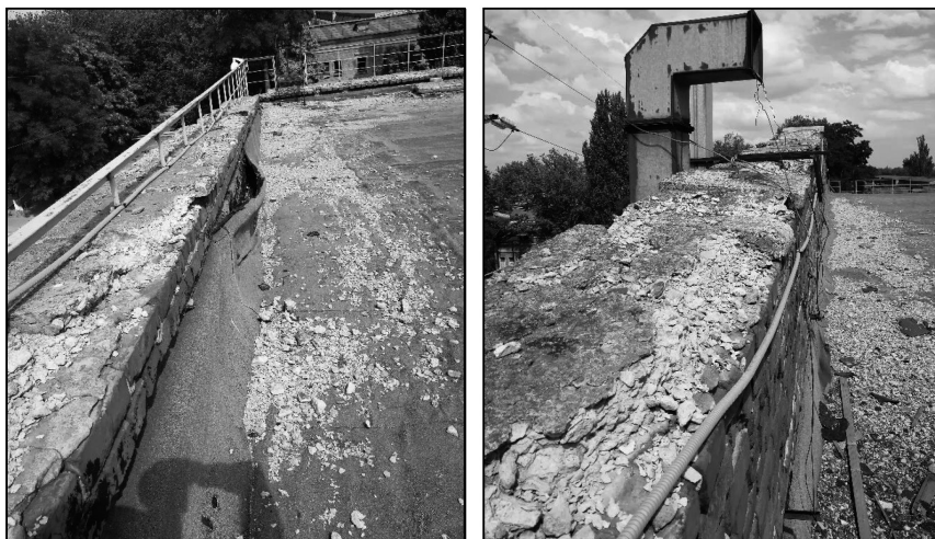
Рис. 10. Разрушение железобетонных парапетных плит
