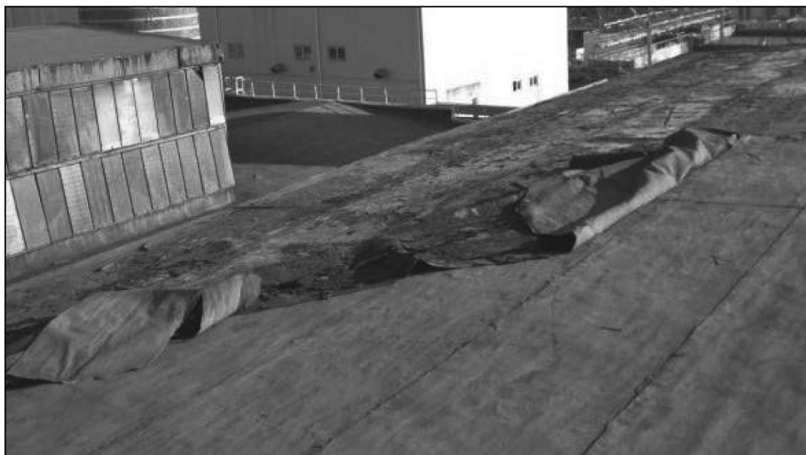
Рис. 3. Отрыв, отслоение кровельного материала
