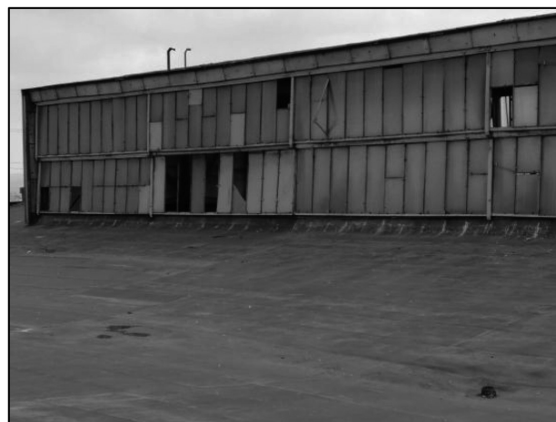
Рис. 13. Разрушение оконного заполнения светоаэрационных фонарей
