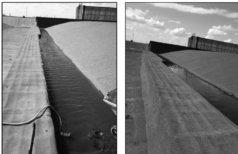
Рис. 12. Отсутствие воронки водостока, застой осадков на кровле
