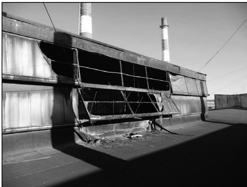
Рис. 16. Разрушение конструкций фонаря в результате аварии или пожара
