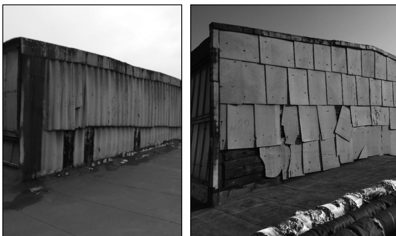
Рис. 15. Разрушение асбестоцементного ограждения фонарей
