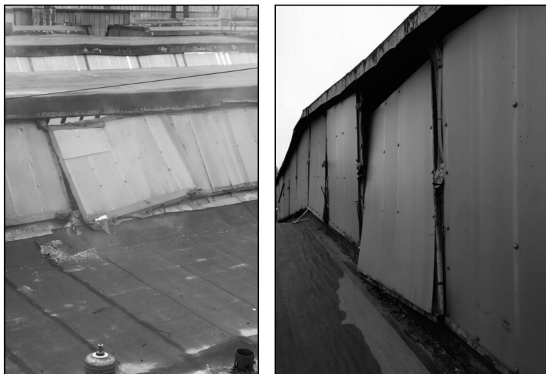
Рис. 14. Отрыв оконных ставней фонаря
