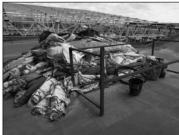
Рис. 5. Захламление кровли оставленными строительными материалами
