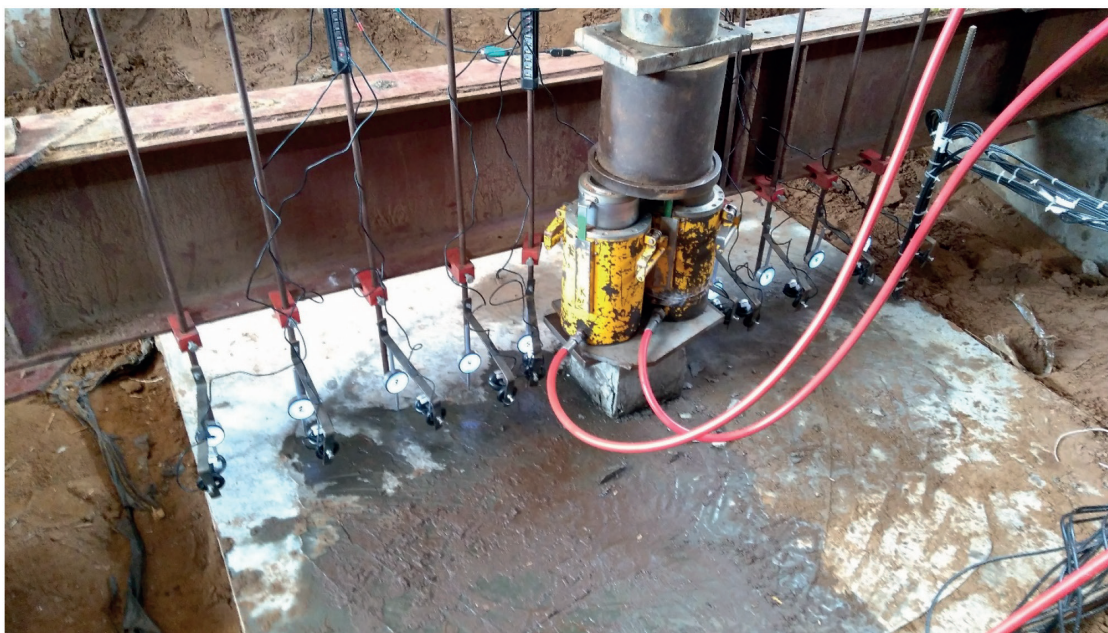
Рис. 5. Установка струнных датчиков давления
