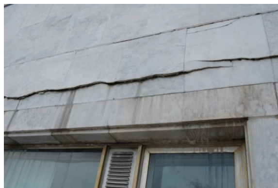
Рис. 2. Характерные дефекты фасадного покрытия
