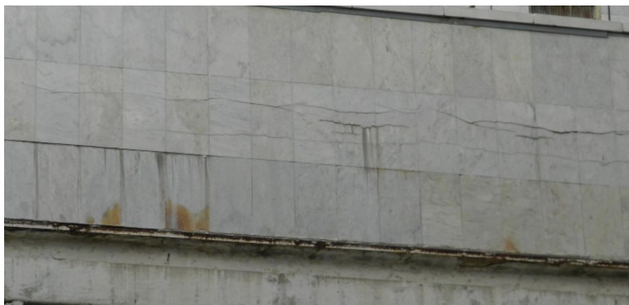
Рис. 5. Выпучивание мраморных плит
