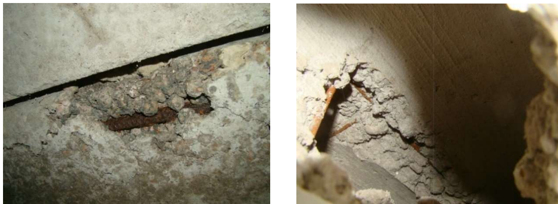
Рис. 4. Участки с неуплотнённым бетоном, непробетонированные ребра плит между пустотами на отдельных участках
