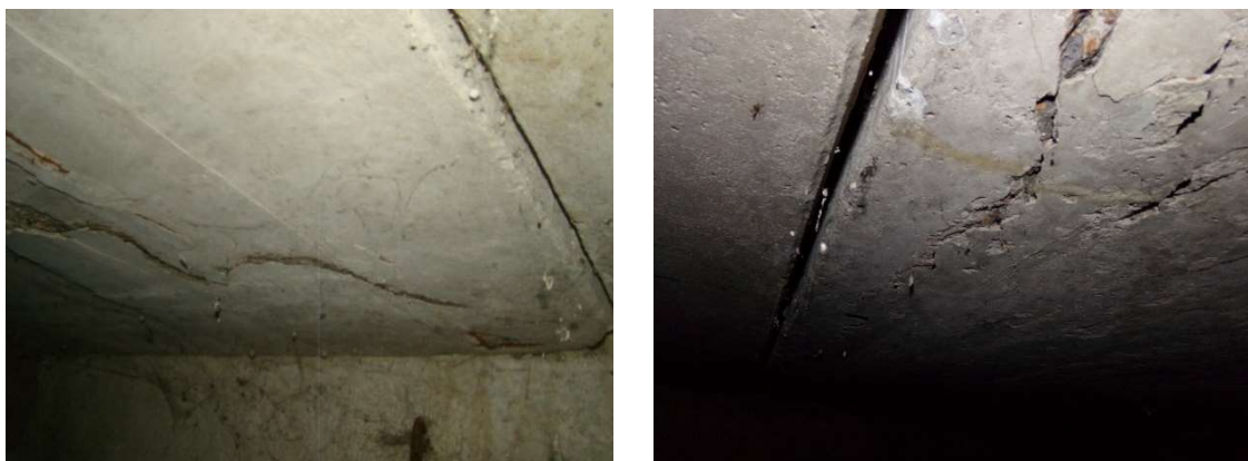
Рис. 5. Повреждения аварийных плит перекрытия
