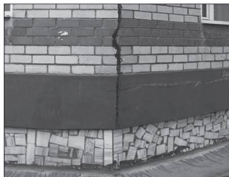
Рис. 3. Трещина в лицевом слое кладки на углу здания
