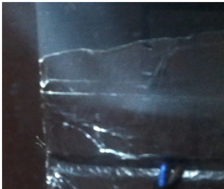
Рис. 4. Задымление установки при перекрытии байпасной камеры в нижней части
