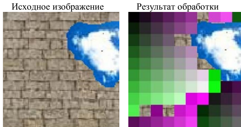
Рис. 5. Выделение дефекта на текстуре кирпичной стены [20]
